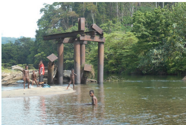
崩れ落ちた伐採道路の残骸
