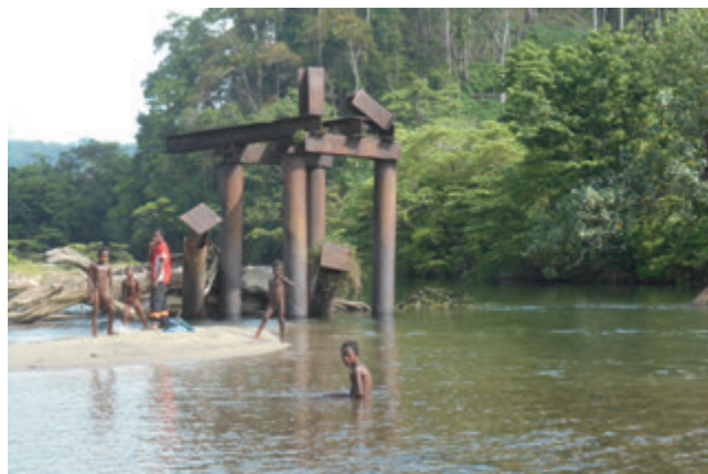
崩れ落ちた伐採道路の残骸
